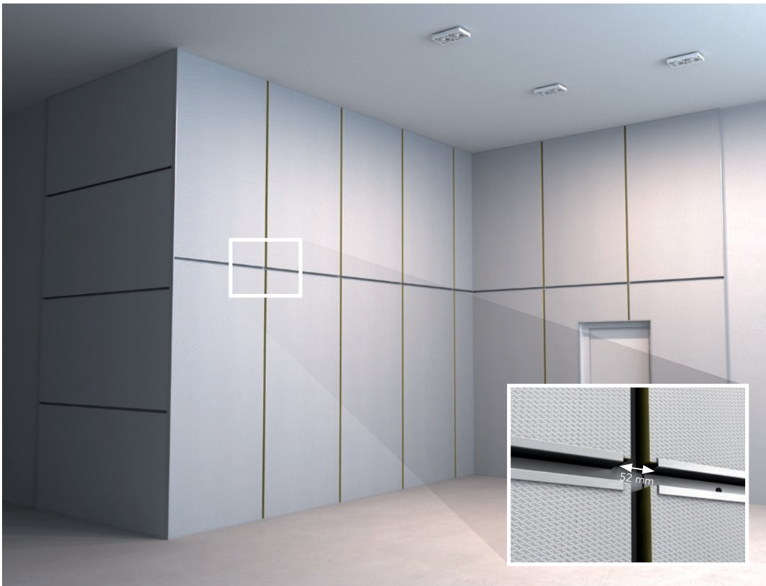
2.4 Montera resterande väggsorbenter och vågräta HAT-profiler genom att arbeta in mot mitten..
