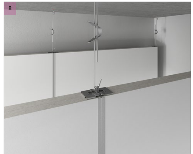
När två bafflar hängs i samma pendel är det viktigt att använda baffelns markeringar så att det blir helt jämnt.
