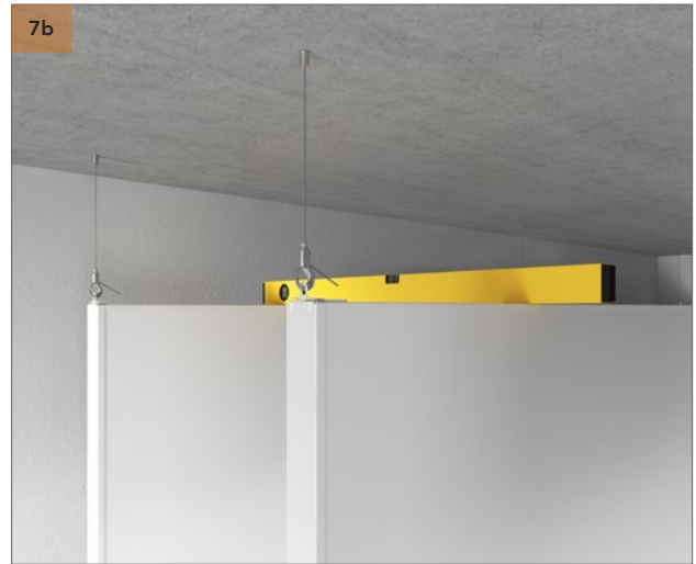
7b Varmista niiden vaakasuoruus asettamalla vesivaaka bafflerin ylä- tai alapinnalle. Suoristaminen voidaan tehdä vapauttamalla koukun lukko ja vetämällä vaimerista.
