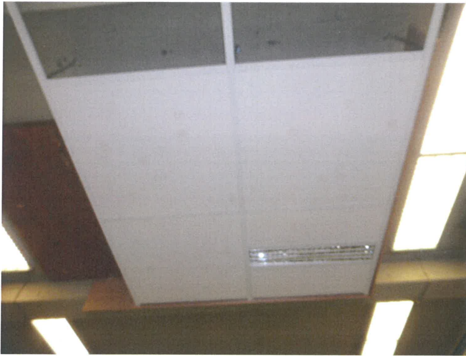
Bild 1 Gesamtansicht: Deckenunterseite mit Rasterleuchte „Olympia Plus“
